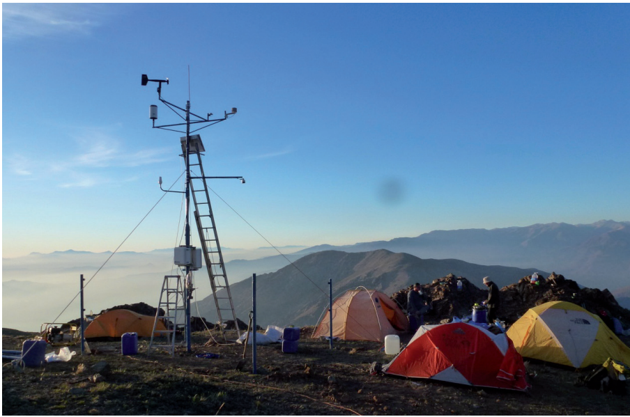
CIGIDEN: Instalación de estaciones de monitoreo hidrometeorológicas en el cerro Tambor (~2.800 msnm), en la Quebrada de Ramón, con el fin de monitorear crecidas frente a eventos extremos.
